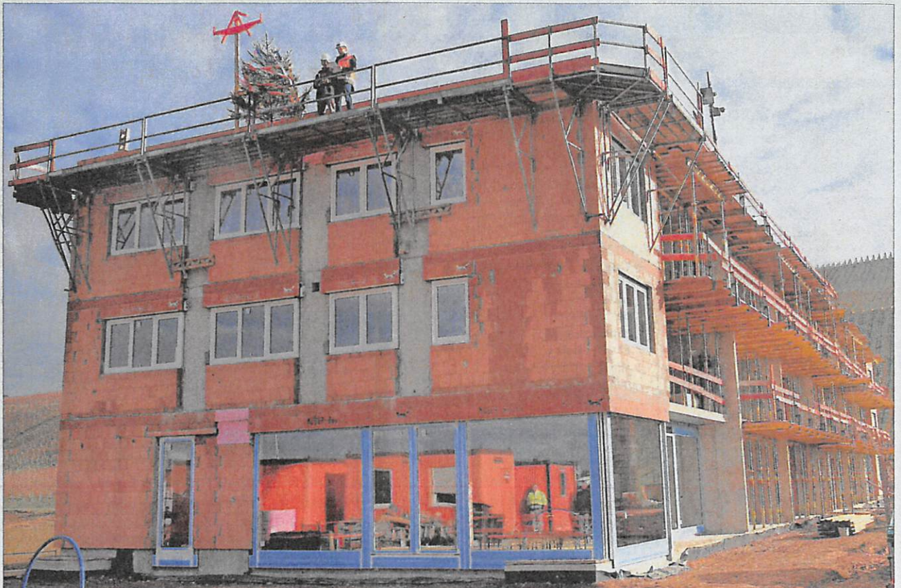
Knapp fünf Monate nach dem ersten Spatenstich für das Auggener Mehrgenerationenhaus wurde schon das Richtfest gefeiert.
