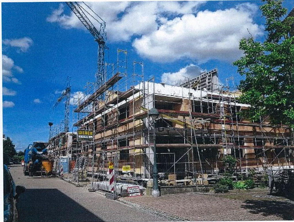
An der Ölstraße in Neuenburg baut die Familienheim Markgräflerland fünf Häuser mit zusammen 21 Wohnungen. Foto: Philipp Foto: Weiler Zeitung
